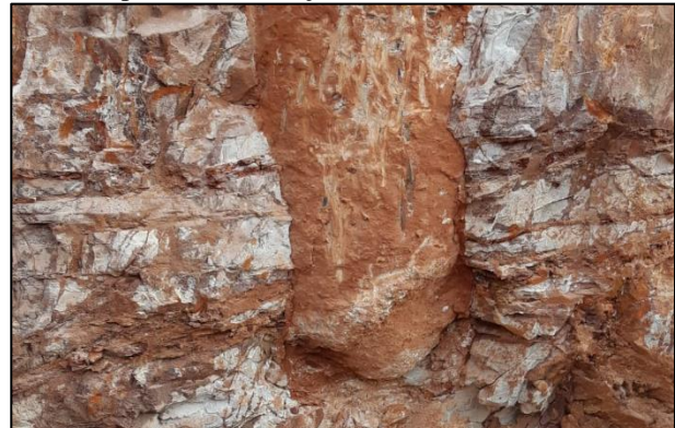
Figura 15. Ponta da estaca hélice contínua paralisada antes da cota prevista em função da resistência do material.
