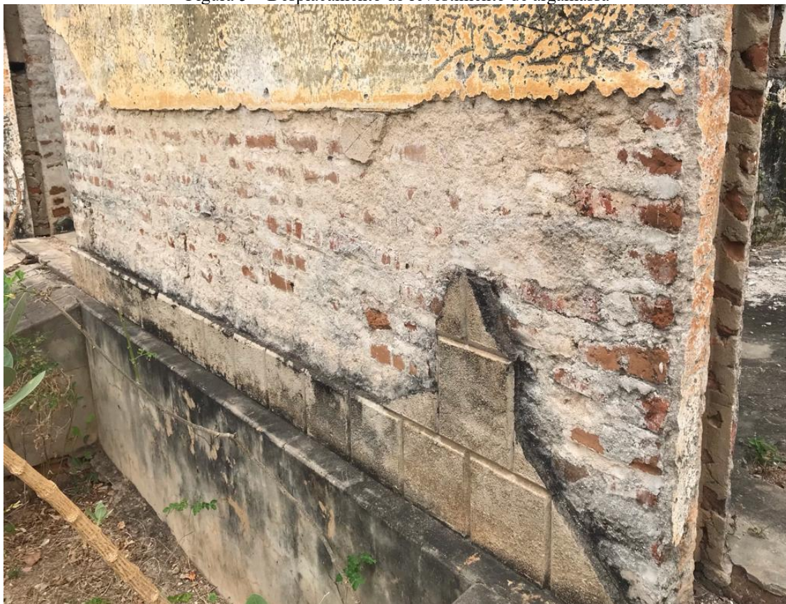
Figura 5 – Deslocamento do revestimento de argamassa
