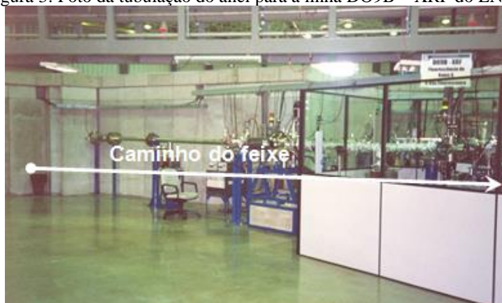
Figura 3: Foto da tubulação do anel para a linha D09B – XRF do LNLS.
