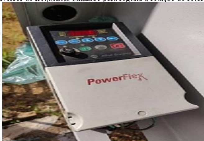
Figura 4 - Inversor de frequência utilizado para regular a rotação do rotor do ventilador
