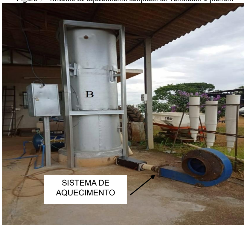
Figura 7 - Sistema de aquecimento acoplado ao ventilador e plênium
