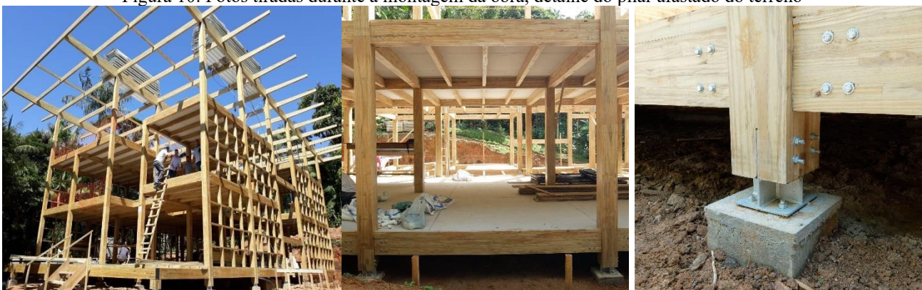
Figura 8 e 9: Fotos tiradas durante a montagem da obra, mostra a estrutura em grelha de MLC Figura 10: Fotos tiradas durante a montagem da obra, detalhe do pilar afastado do terreno
