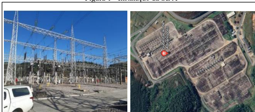
Figura 1 - Instalação da SE A
