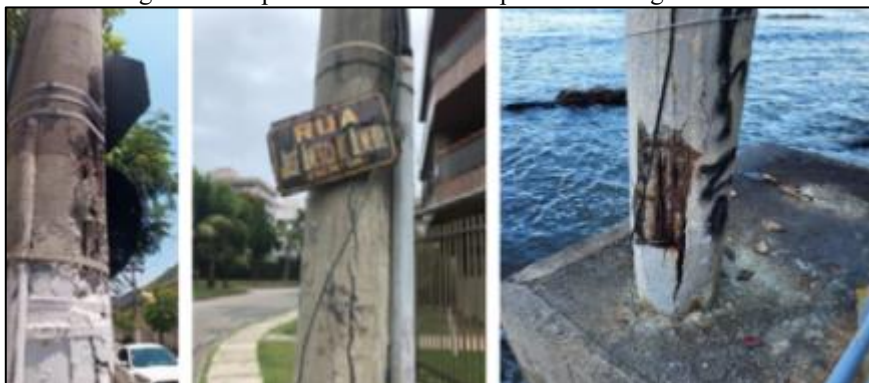
Figura 1 – Aspecto da corrosão nos postes de energia elétrica
