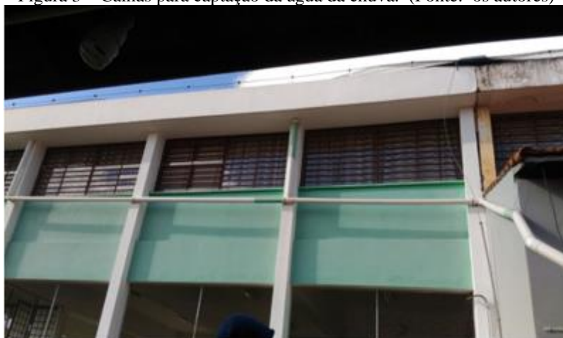
Figura 3 – Calhas para captação da água da chuva. (Fonte: os autores)
