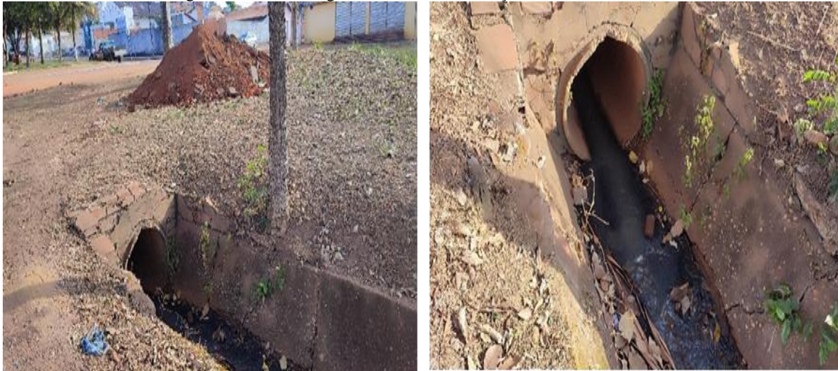
Figura 22: foco de esgoto doméstico em direção ao balneário bueira
