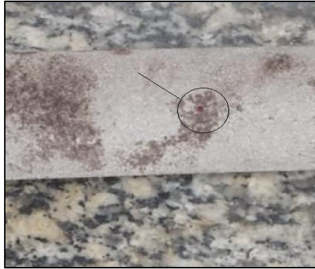
Figura 5 - Danos causados, furos que atravessam toda a espessura. Fonte: O autor.
