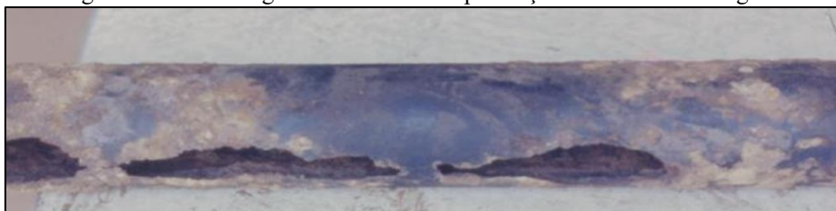
Figura 8 – Corrosão gráfitica associada à presença de sulfeto de hidrogênio
