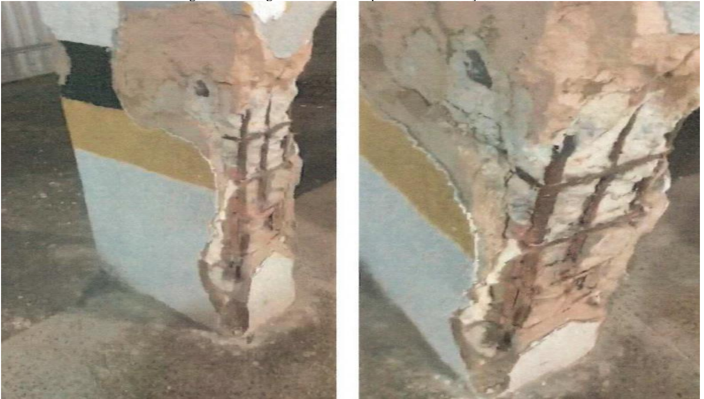
Figura 5: Patologias existentes nos pilares de sustentação
