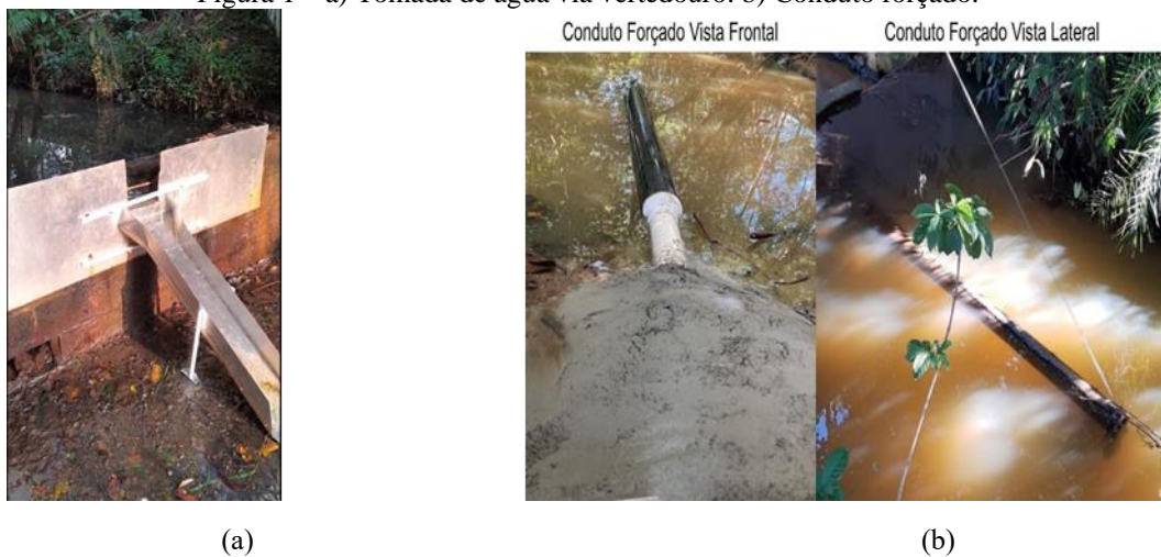
Figura 1 – a) Tomada de água via vertedouro. b) Conduto forçado.
