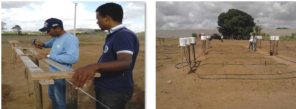
Figuras 4. Montagem da bancada para suspensão dos reservatórios que alimentam o sistema de irrigação por gotejamento
