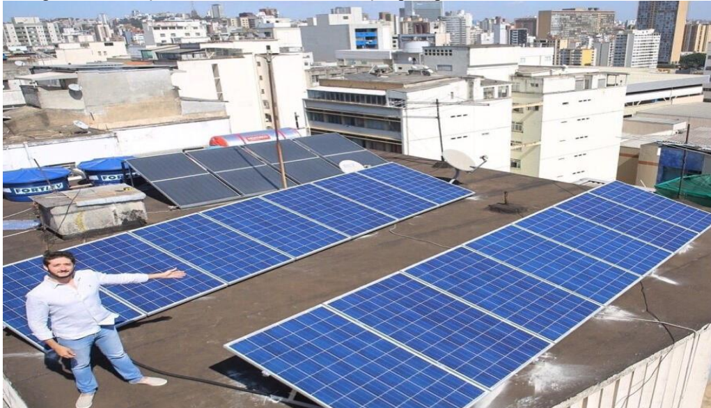
Figura 4. Instalação de módulos com a inclinação para painéis bifaciais em cobertura de concreto
