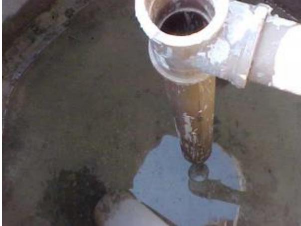
Figura 4: Detalhe do sistema em entrada interna do RAC
