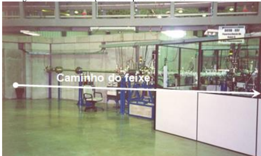
Figura 8: Foto da tubulação do anel para a linha D09B – XRF do LNLS.
